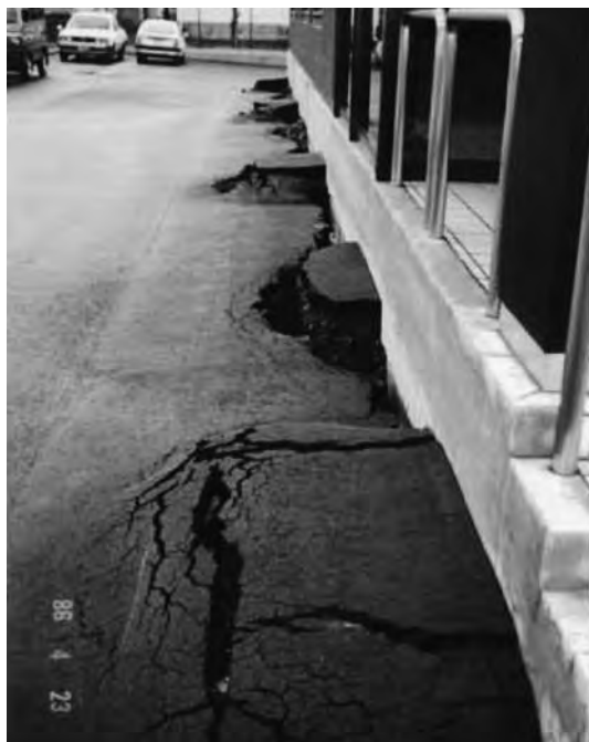
深刻化した地盤沈下
