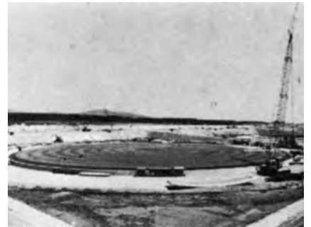
タンク底板工事に入ったむつ小川原石油国家備蓄基地建設工事A工区
